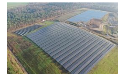
Foto: Op het zonnepark Bovenveld zijn ruim 17.000 zonnepanelen geplaatst die gezamenlijk zo'n 7 megawatt elektriciteit opleveren, voldoende om jaarlijks 1.850 huishouden te voorzien van elektriciteit.
